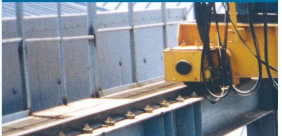
오픈윈치호이스트 (open winch hoist)
